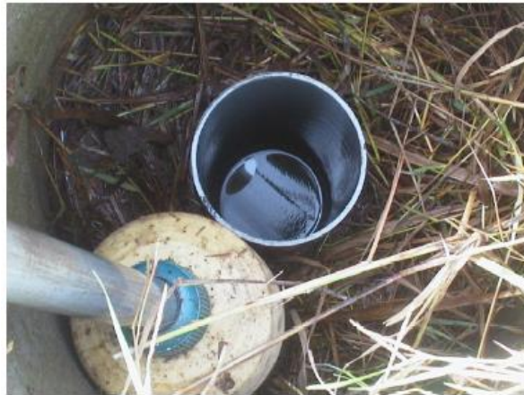
شکل ۴- چاهک کنترل جهت باز و بسته کردن تخلیه زه‌آب‌ها
